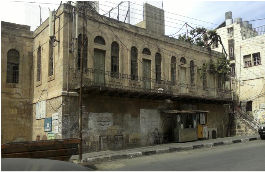
الصورة (4-4) : مبنى قديم في حالة سيئة (المصدر : الباحثة)
