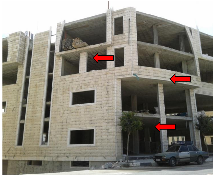
الصورة (4-8) : مبنى قيد الانشاء يحتوي عدة اخطاء هندسية (المصدر : الباحثة)
