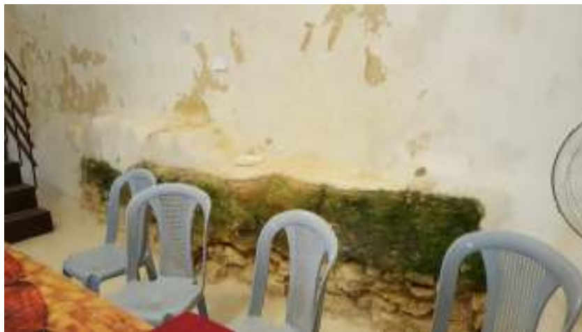
شكل (46.4): حوش ندى الشعبي المبنى تأثير البئر على احد الجدران الداخلية للمبنى.
