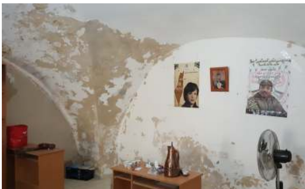
شكل (36.4): مبنى حوش محمود عثمان - الرطوبة في احدى الغرف.
