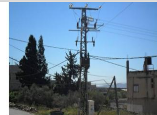
خطوط شبكة كهرباء
