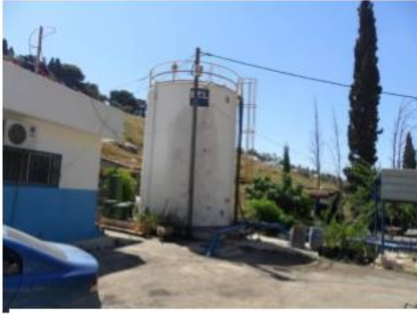
خزان توازن مياه
