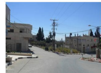
خطوط كهرباء ضغط متوسط
