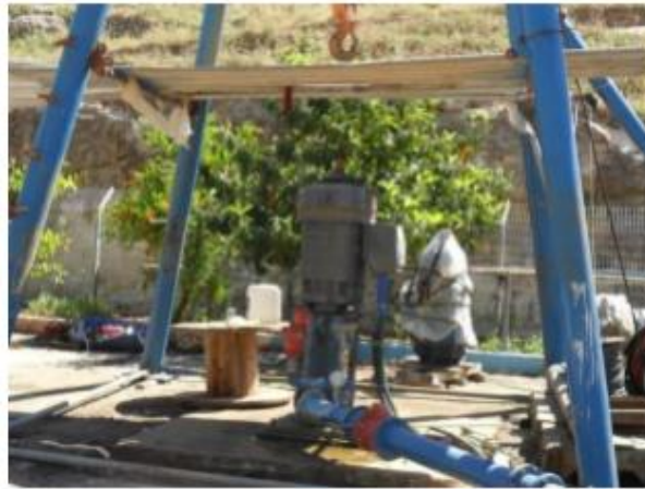
محطة ضخ مياه
