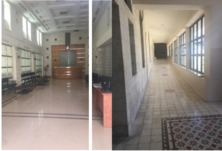
شكل 71: صورة توضح الفرق بين تشطيبات المبنى القديم الى اليمين والمبنى الجديد إلى اليسار في المستشفى الانجليي
