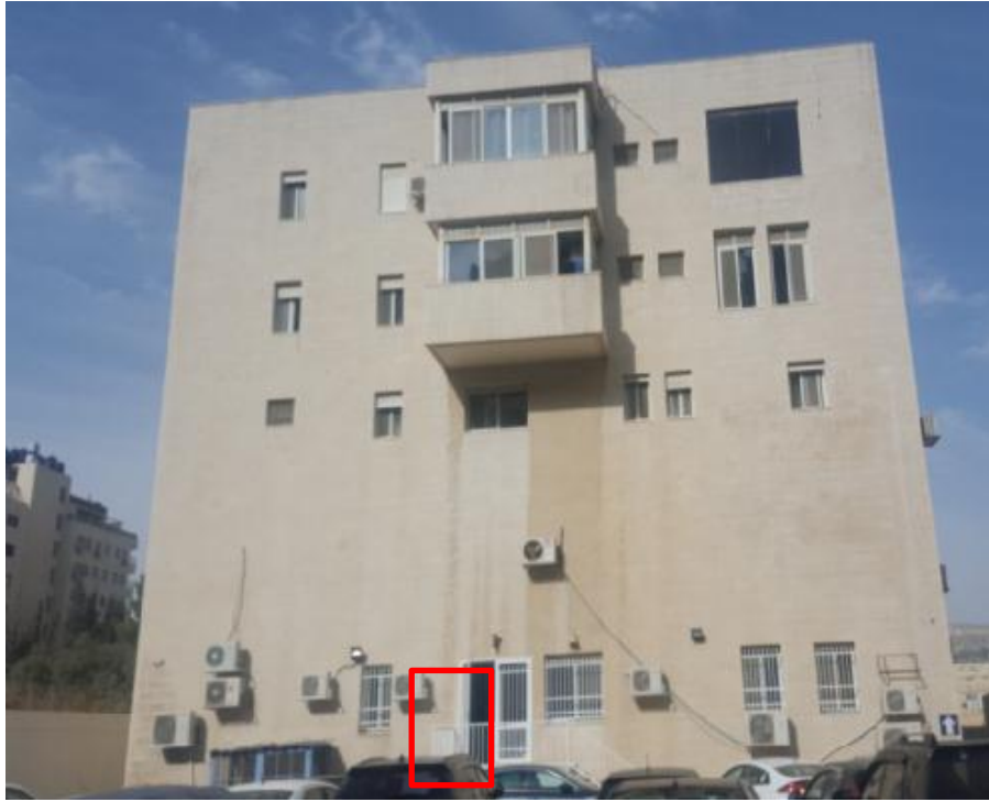
شكل 65: استخدام مخرج الطوارئ كمدخل للعيادات الخارجية في مستشفى نابلس التخصصي المصدر: ( الباحثة)
