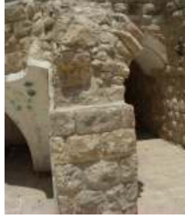
شكل (2-17) صورة لجدار متهدم يظهر فيه سماكة جدار العالي في المباني القديمة بالخليل.
