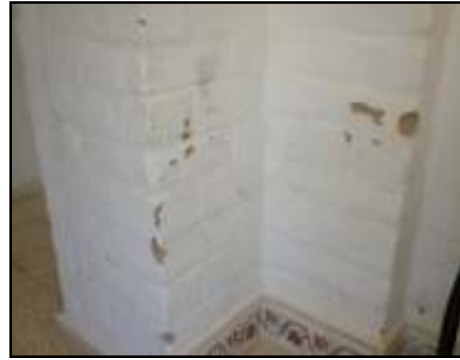
صورة (6: 18): خدوش وحفر في الطوب الطيني لواجهات مركز عقبة جبر النسوي (المصدر: الباحثة.2014)
