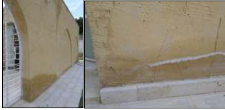
صورة (6: 17): ظهور الرطوبة في الأجزاء السفلية من جدران مبنى عقبة جبر النسوي (المصدر: الباحثة.2015)
