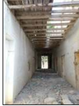
صورة (5: 17): المرحلة الثانية من إنشاء سقف الطابق الأرضي في فندق القصر الشتوي (المصدر: الباحثة)
