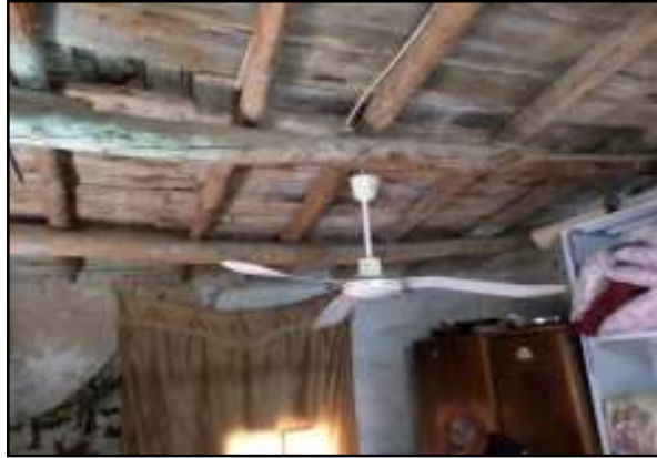
صورة (5: 27): تقوس الجسور الخشبية وتشقق الجدران الداخلية الناتج عن تسرب مياه الأمطار
