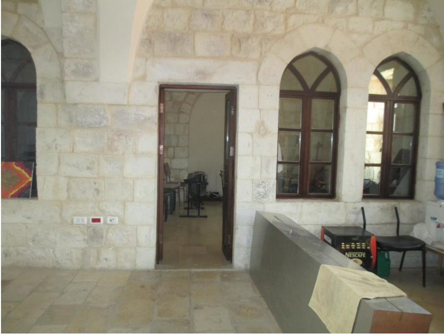
الشكل (3.20): نمط الفتحات المطلة على القاعة الوسطى في الطابق الأول لمركز أوتار المصدر: (وحدة المباني القديمة التابعة لبلدية نابلس، 2019).
